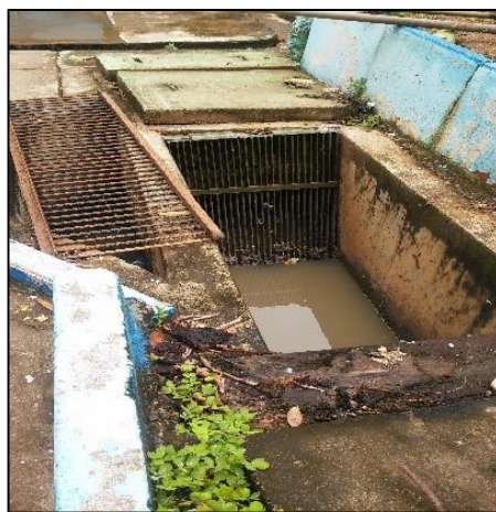
b. Cámara Seca de la EBAR
