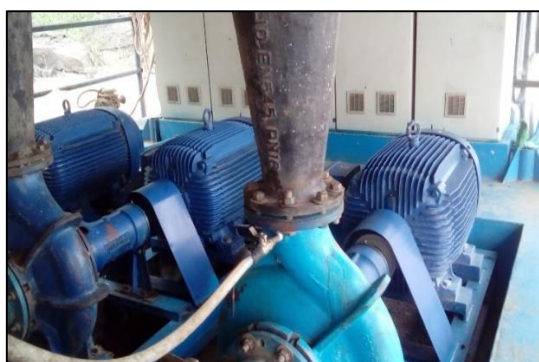
Imagen N° 5: Vista de las electrobombas de la captación La pastora
