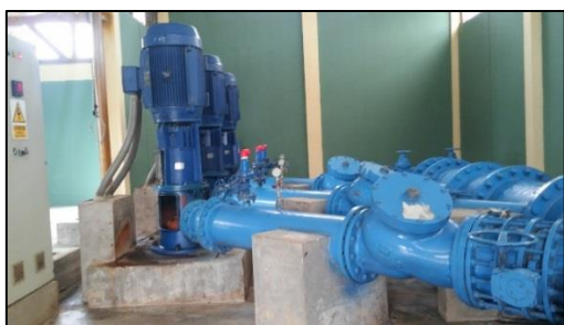
a. Estación de Bombeo
