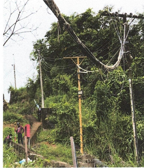
Zona de acceso y sistema de abastecimiento de energía eléctrica perjudicado y deteriorado
