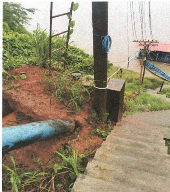
Línea de impulsión perjudicada
